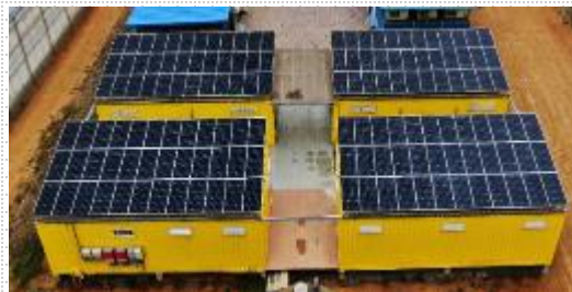
太陽能屋頂發電系統
